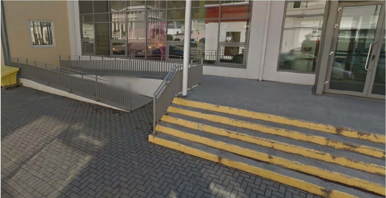
Mynd 5-2: Suðurlingangur Grunnskólans. Bæta þarf við handriði við tröppur og einnig við skábraut. Mála þarf þrep neðstu tröppu og setja viðvörunarfleti á efsta þrep. Mögulega er hægt að staðsetja hurðaopnara á hlið hússins (eldri byggingar)
