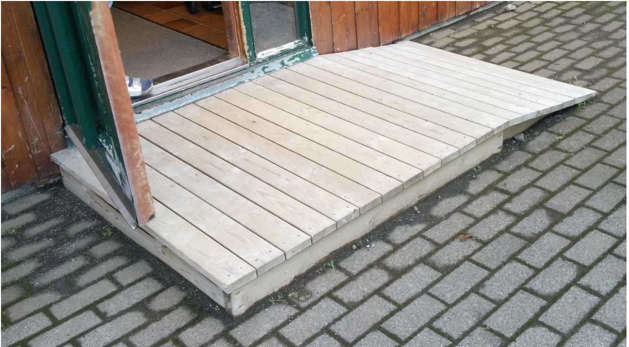
Mynd 4-6: Inngangur að leikskólanum á Suðureyri. Myndin sýnir núverandi skábraut. Við enda skábrautarinnar væri æskilegt að hafa 2x2m pall, þar sem dyraopnari væri staðsettur.
