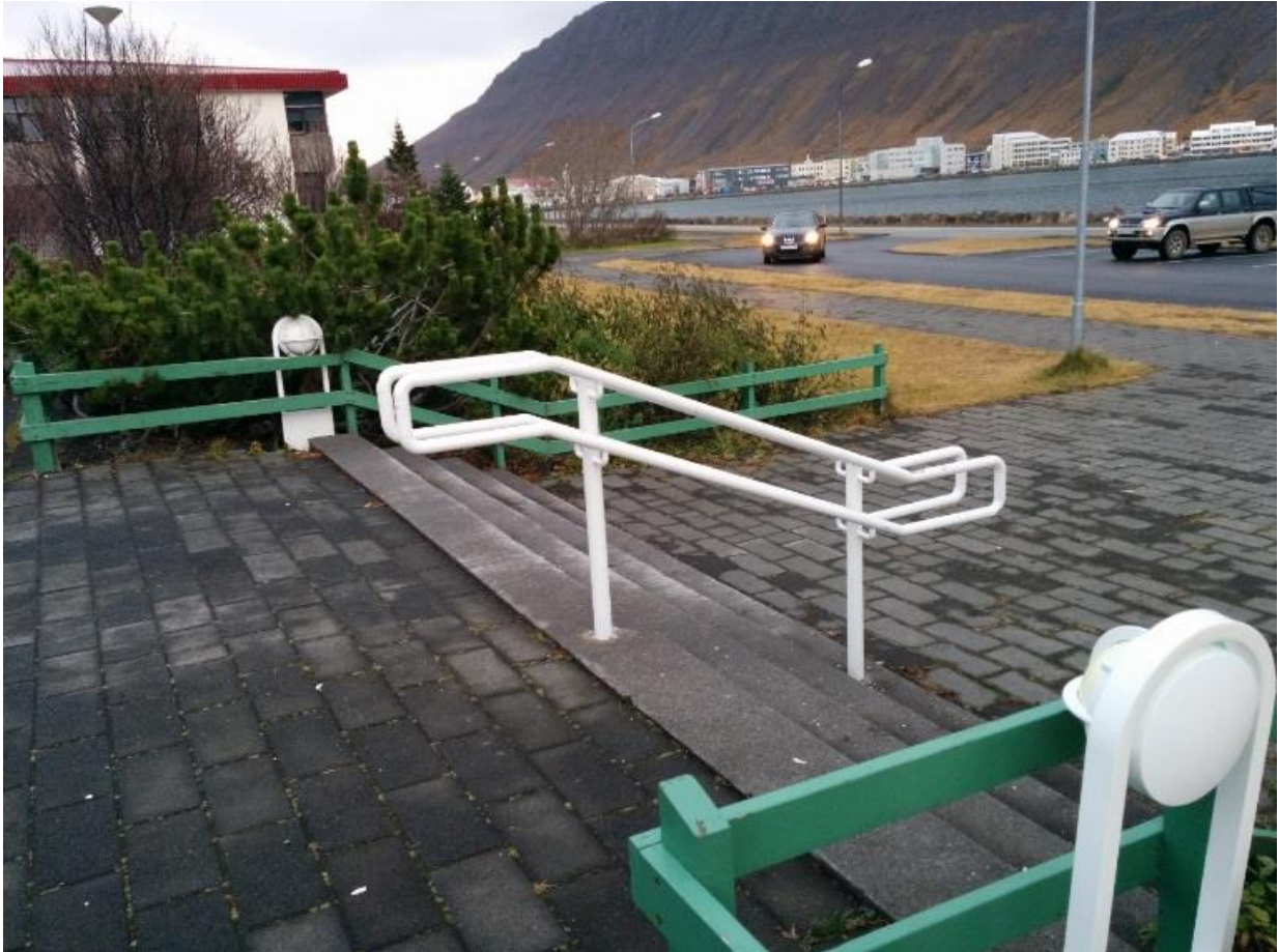
Mynd 5-11: Tröppur við inngang íþróttamiðstöðvarinnar. Endurbætur felast í merkingum á tröppum, viðvörunarfleti ofan við efsta þrep og uppsetningu á handriði.
