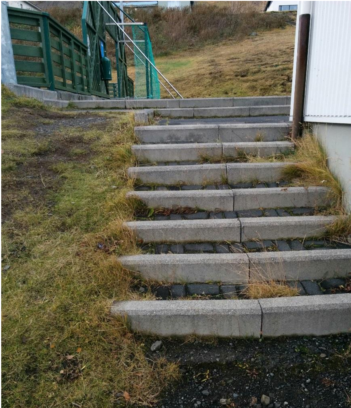
Mynd 2-10: Myndin sýnir tröppur sem liggja að leiksvæði við grunnskólann á Þingeyri. Mishátt uppstig er í tröppurnar og mikið um misfellur. Handrið vantar og skábraut þyrfti að vera við hliðina á tröppunum
