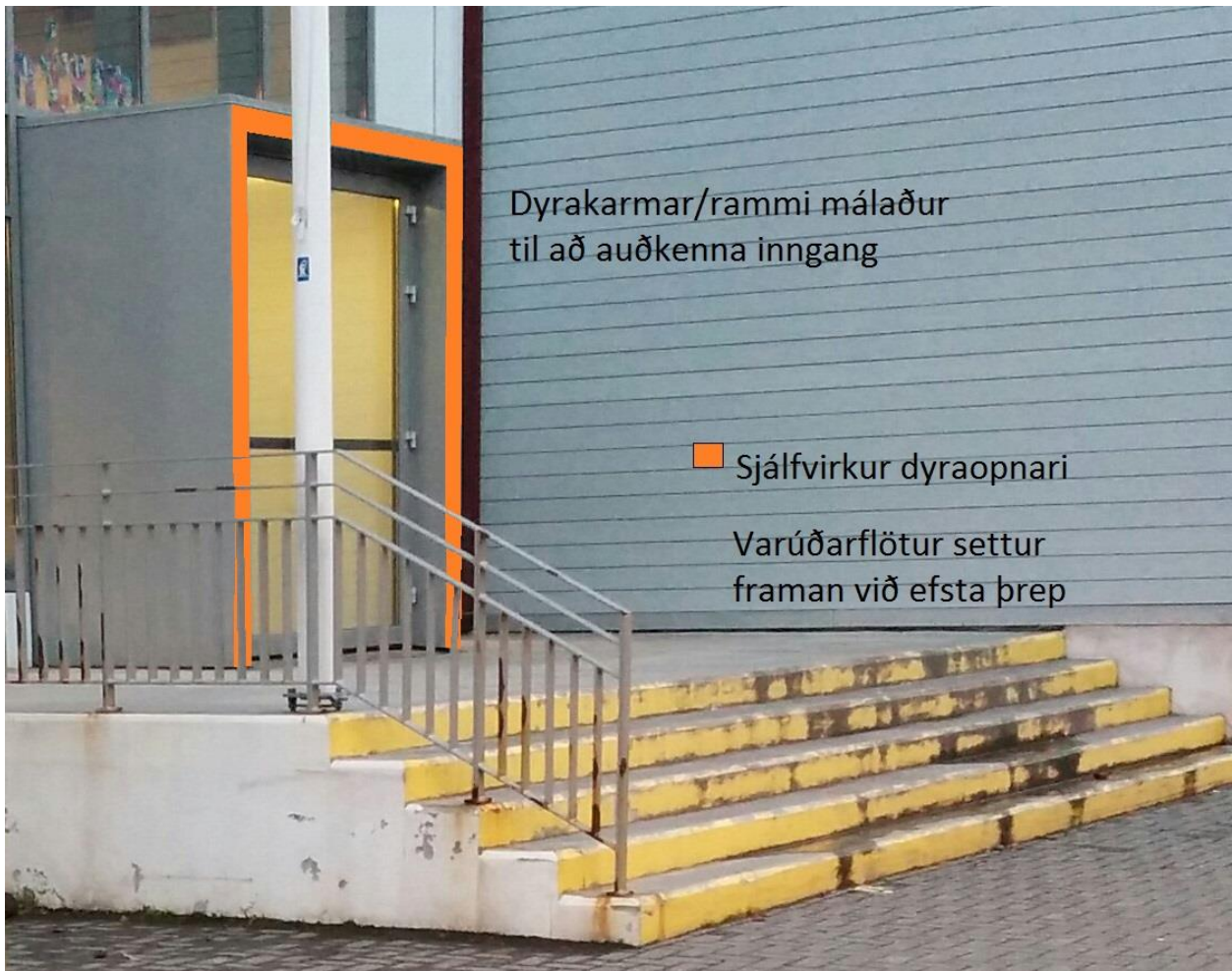
Mynd 5-4: Suðuringangur Grunnskólans, myndin sýnir staðsetningu á dyraopnara og varúðarflötum. Dyrakarma þarf að mála til að auðkenna inngang og það þarf að bæta við öðru handriði sem og lengja handrið svo það nái 30cm út fyrir neðstu tröppu.
