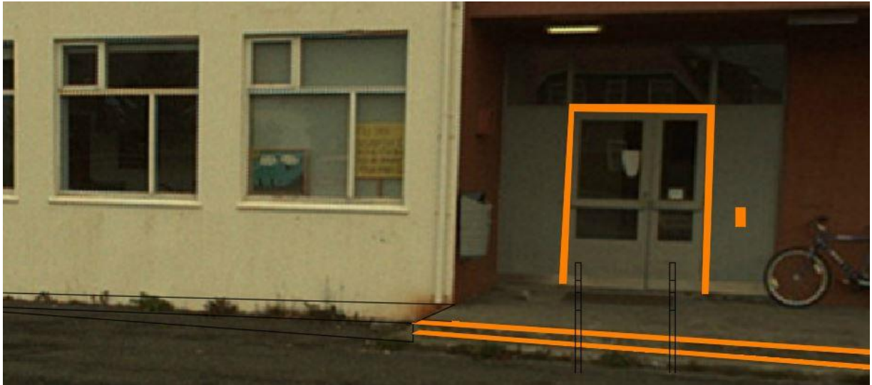
Mynd 3-2: Myndin sýnir aðalinngang að grunnskóla Flateyrar (Önundarfjarðar). Myndin sýnir hvar möguleg skábraut gæti verið staðsett. Hér þarf einnig að lagfæra tröppur svo að uppstig sé jafn hátt, hækka pall svo að innstig í byggingu sé ekki meira en 2cm (með ávölum þröskuldi), staðsetja handrið við tröppurnar, setja sjálfvirkan dyraopnara, bæta lýsingu og mála dyrakarma svo að inngangur verði sýnilegri.
