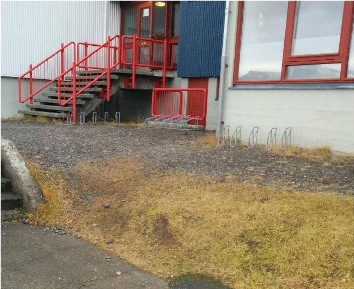
Mynd 2-11: Myndin sýnir Norðuringang grunnskólans á Þingeyri. Stígur sem liggur upp að grunnskólanum er í slæmu ásigkomulagi, með mikið af misfellum. Tröppur eru á tveimur pöllum og eru tröppurnar á neðri pall í slæmu ásigkomulagi, mikið um sprungur og mishátt uppstig og það vantar handrið öðru megin. Tröppur á efri pall eru með of hátt neðsta stig, handrið nær ekki nægilega langt út fyrir neðstu tröppu og það vantar annan handlista á handriðið.
